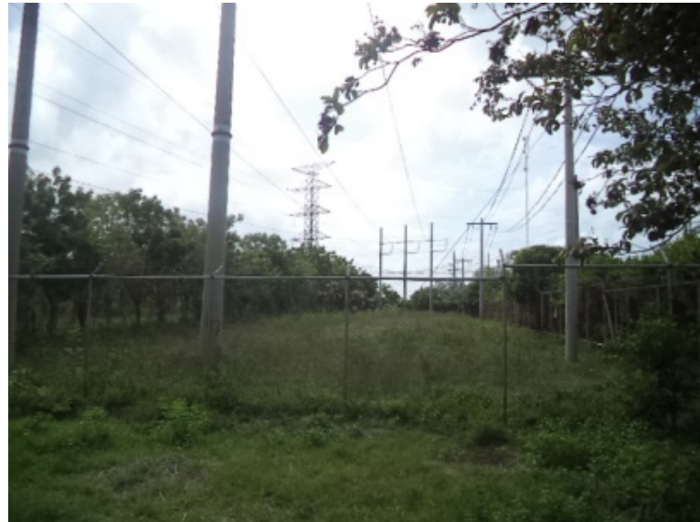
Entrada a reacondicionar en subestación Masaya
