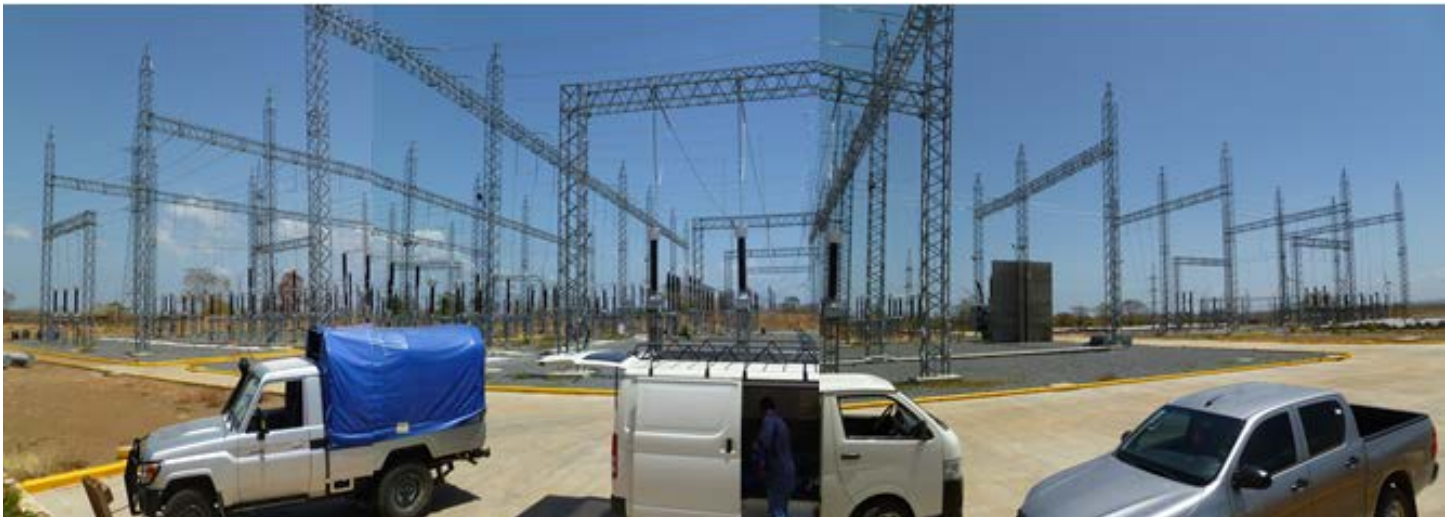
Vista Panorámica Patio de Subestación La Virgen, Rivas, Nicaragua
