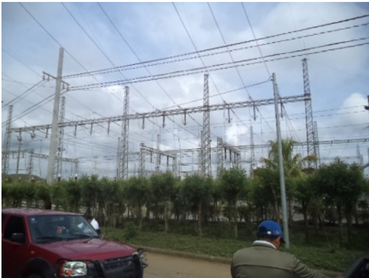
Subestación Masaya reconfiguraciones necesarias
