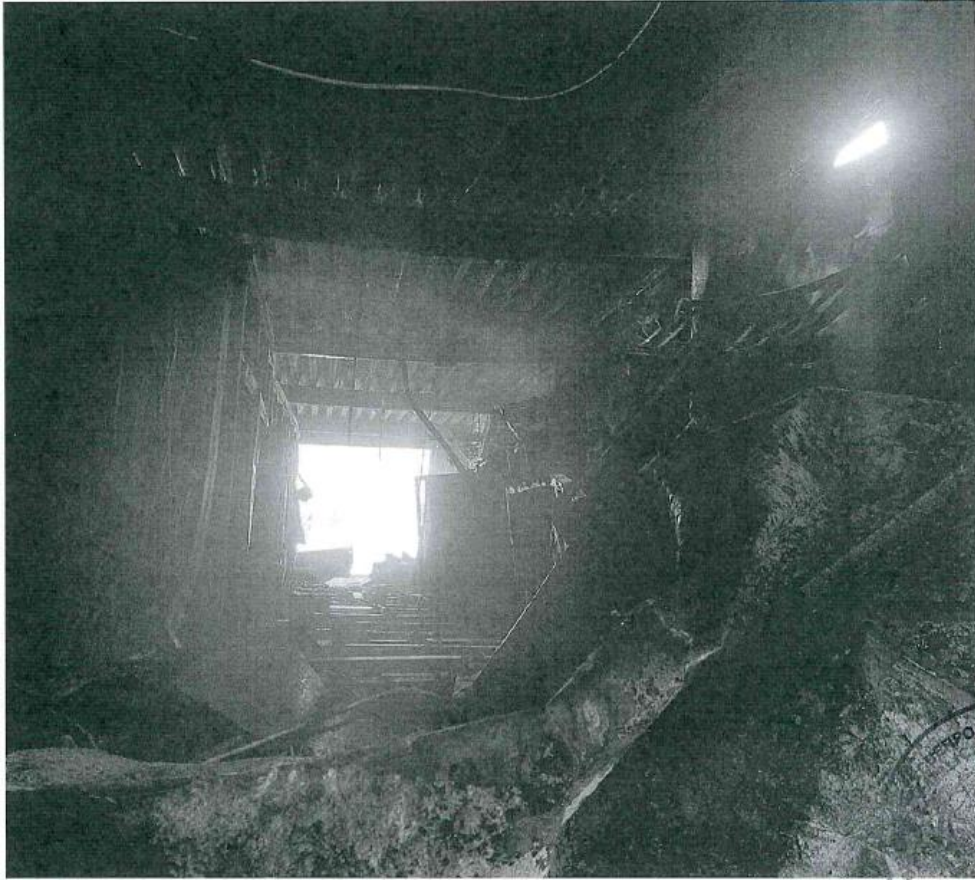
Figura 19. Zona de origen del incendio
