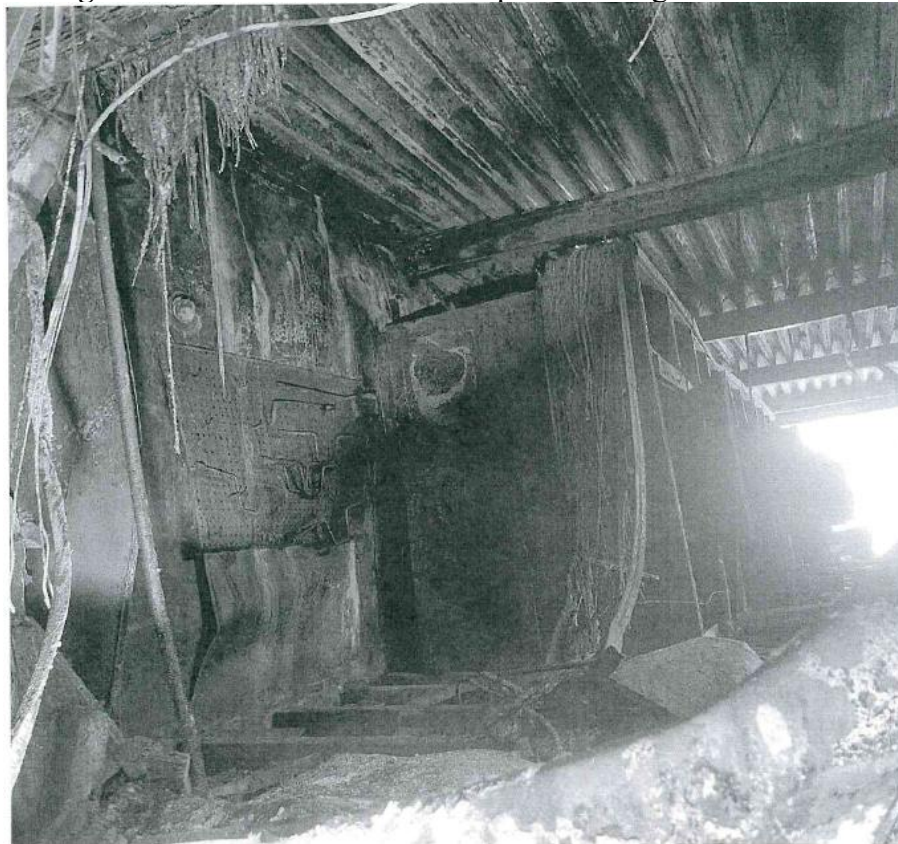
Figura 18. Área donde se ubica el punto de origen del incendio
