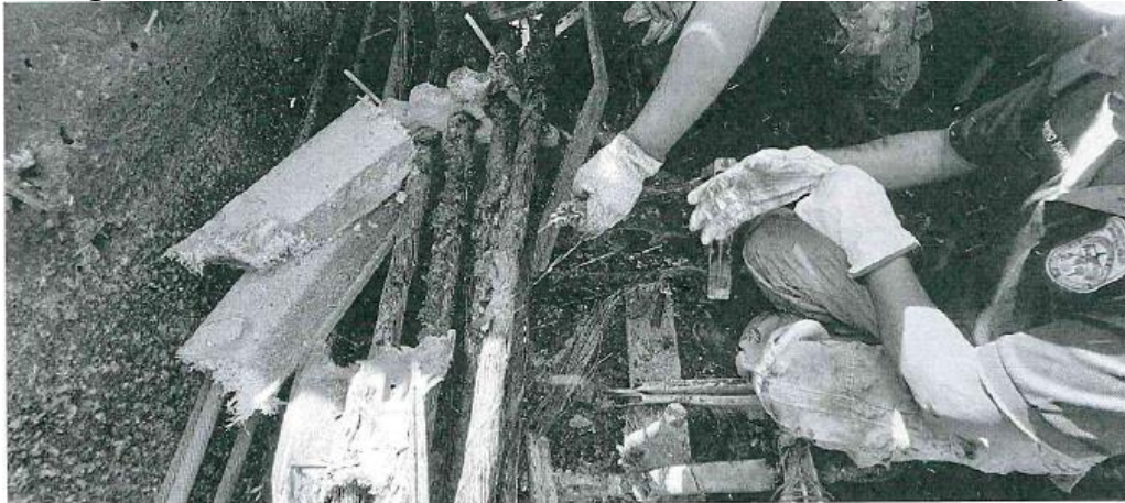
Figura 22. Punto de falla del transformador #1 del lado de medio voltaje
