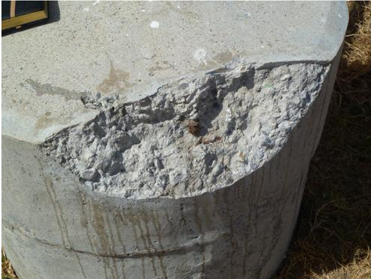
Daño a Pilastra por Rayo torre 95 tramo 9
