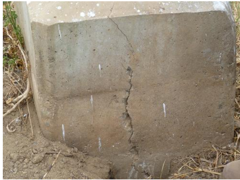
Otra pilastra dañada torre 118, tramo 9
