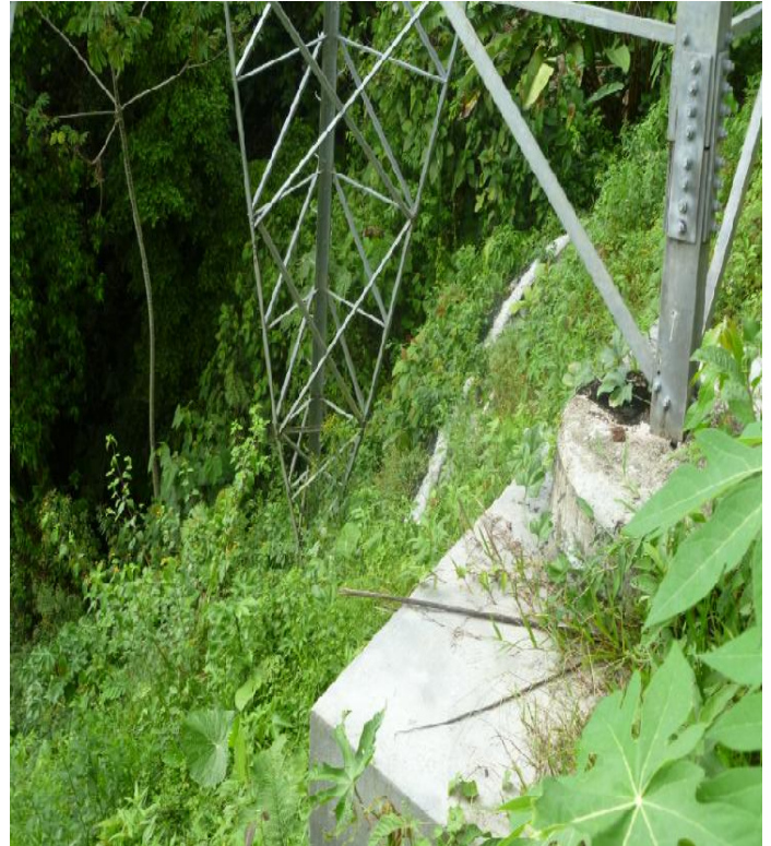
Torre con pendiente muy inclinada, muchas requieren obras de mitigación
