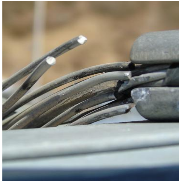
Rotura Hilos de Guarda
