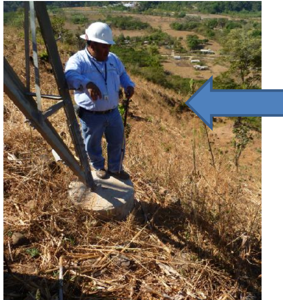
Talud se está agrietando y desplazando, obra de protección a definir por análisis geotécnico
