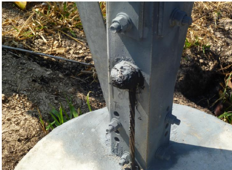
Cubierta de conectores de tierra con tela-asfalto para evitar robos
